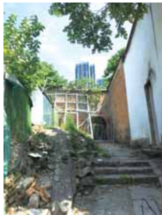
等待修复的龙岭顶古道
